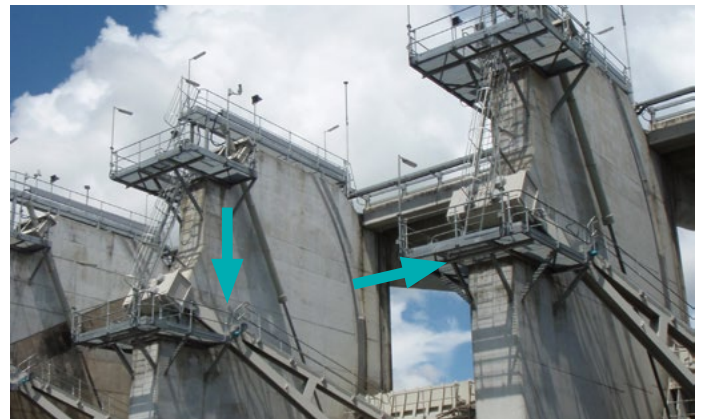
Photo d'une installation
